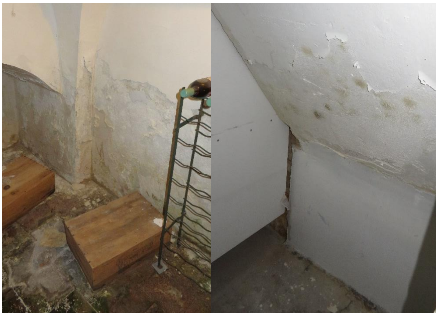
Figuur 11: Links: Optrekkend vocht in de kelder onder de regentenkamer Rechts: Schimmelvorming in half verdiepte kelder in een wooneenheid
